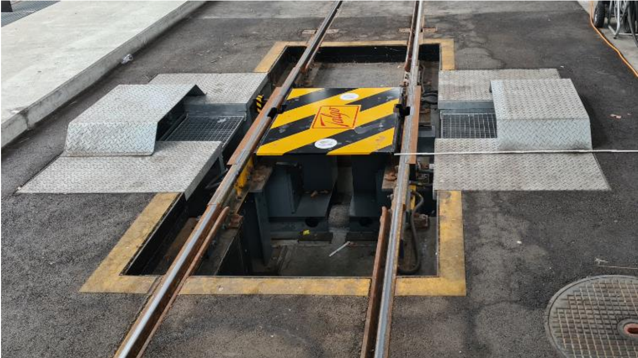
Figure 1 Installation de mesure des profils de roue de TALGO. [1]
