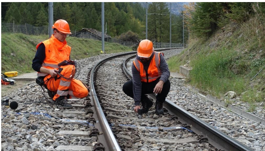
Abbildung 12: Hammermessungen an der Fahrbahn im Bogen „Biel“ der MGB
